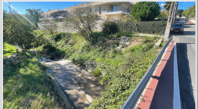
Reconnaissance de site pour l'exemple Vallon de Roquebillière aval (Boulevard du Soleil)
