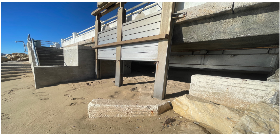
Vue des martelières (vannes à guillotines) de l'exutoire en mer du vallon du Devens sur la plage du Midi Cannes la Bocca
